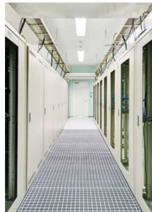
冷えた外気が吹き出すコールドアイル側
